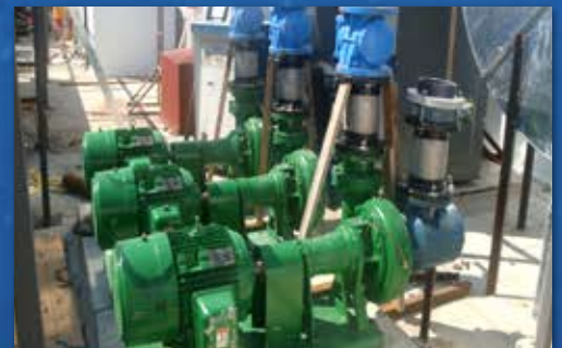
Chiller y Generadores de Agua Helada
