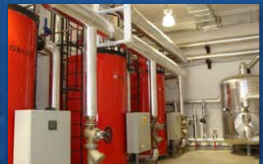
Cuarto de Máquinas
