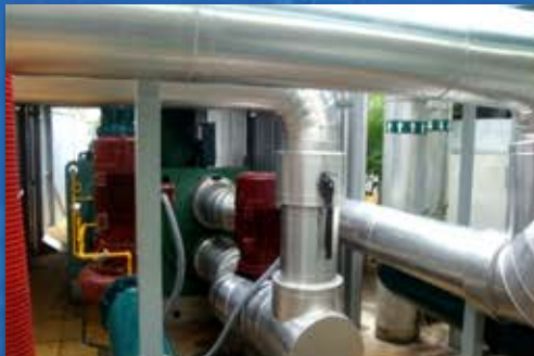
Cuarto de Máquinas Mayan Palace
